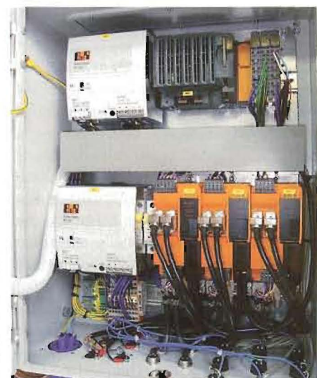
Kompakte Gesamtautomatisierung für Medusa: Netzteile, X20-Module und drei ACOPOSmicro-Stepper-Controller für die B&R-Schrittmotore
