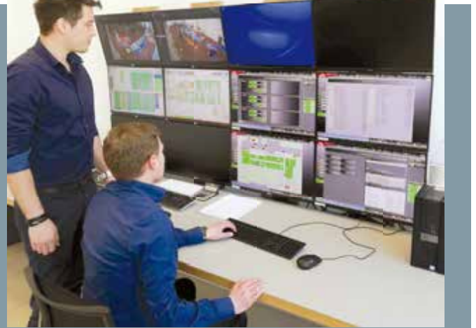
An einem Leitstand pro Standort werden auf mehreren Bildschirmen alle Betriebszustände übersichtlich dargestellt.
