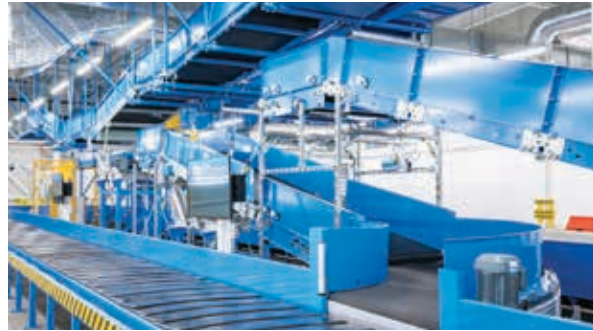
Rund 1.000 Förderanlagen bilden das Gepäckförder-system am internationalen Flughafen Budapest Liszt Ferenc (BUD). © Baranyi Róbert, Budapest Airport
