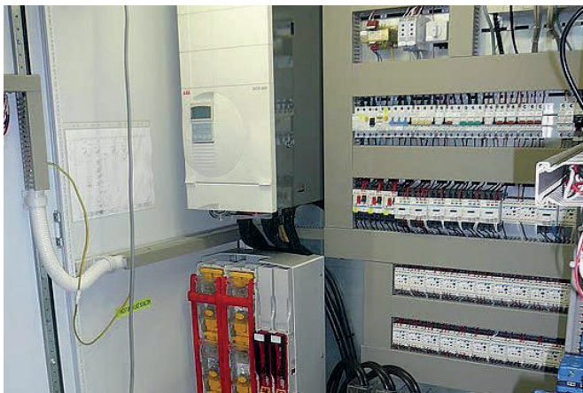
Elektroanlagen von Elektro Berchtold sorgen für den reibungslosen Betrieb von Seilbahn- und Beschneiungsanlagen.
