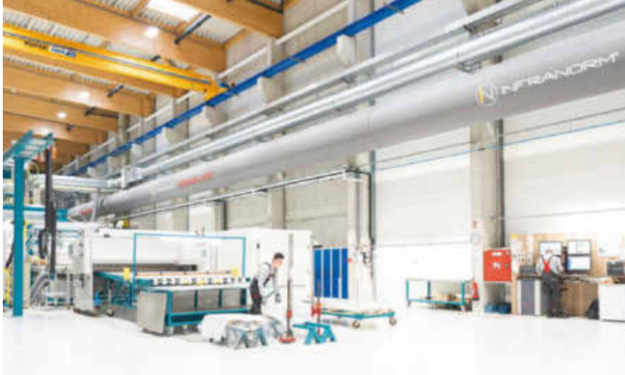
Die textilen Luftauslässe für die Lufteinbringung werden passend zur Hallengeometrie individuell angefertigt.
