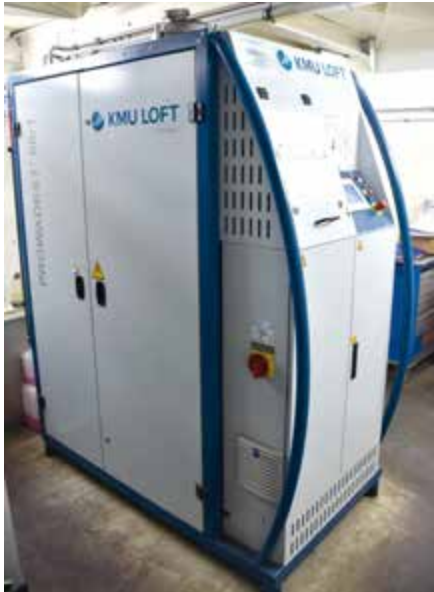
Die Reinigung des Spülwassers erfolgt in einem Vakuumverdampfer Prowadest P60/1 der KMU Loft Cleanwater GmbH.
