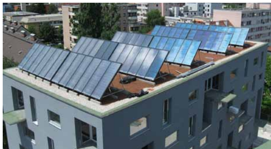
Solarthermie auf dem Vormarsch: 1.550 m 2 Kollektorfläche tragen dazu bei, die 289 Wohnungen der Wohnanlage „Stadtwerk Lehen“ in Salzburg energieautark zu machen. Hergestellt wurden die Kollektoren vom Tiroler Hersteller TISUN GmbH auf Produktionsanlagen des oberösterreichischen Herstellers DTEC dynamic technology GmbH.
