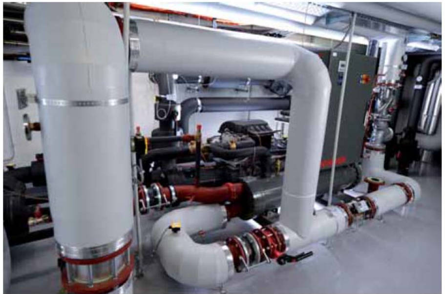
Die Aggregate zur Wärmegewinnung aus dem Grundwasser stammen von der Firma OCHSNER: Die verwendete Großwärmepumpe IWWT400ER2 mit Turbo-Kompressor ist mit reibungsfreien Magnetlagern ausgestattet. Sie benötigt einen Anlaufstrom von nur fünf Ampère und zeichnet sich neben einem höheren Wirkungsgrad auch durch eine besondere Geräuscharmheit aus.
