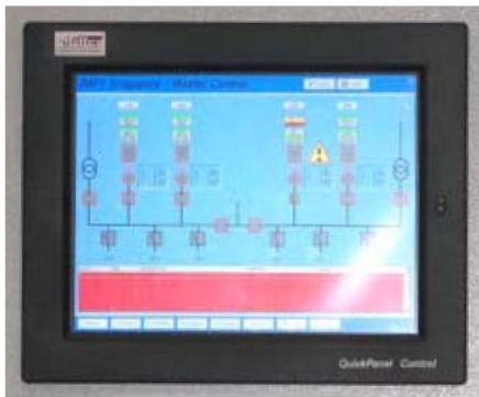
Kompakte, klare Steuerung und Visualisierung der Gesamtanlage.
