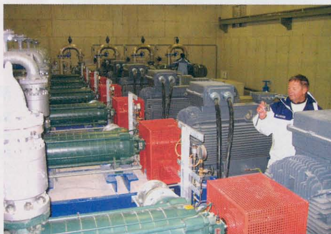
Sehr gute Zugänglichkeit für Wartungsarbeiten trotz bester Raumausnutzung
